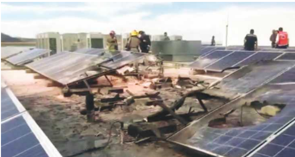
Incendio de seis PSFVs en el techo de la Ciudad Judicial Federal en Guadalajara, Jalisco, el 22 de febrero de 2018
